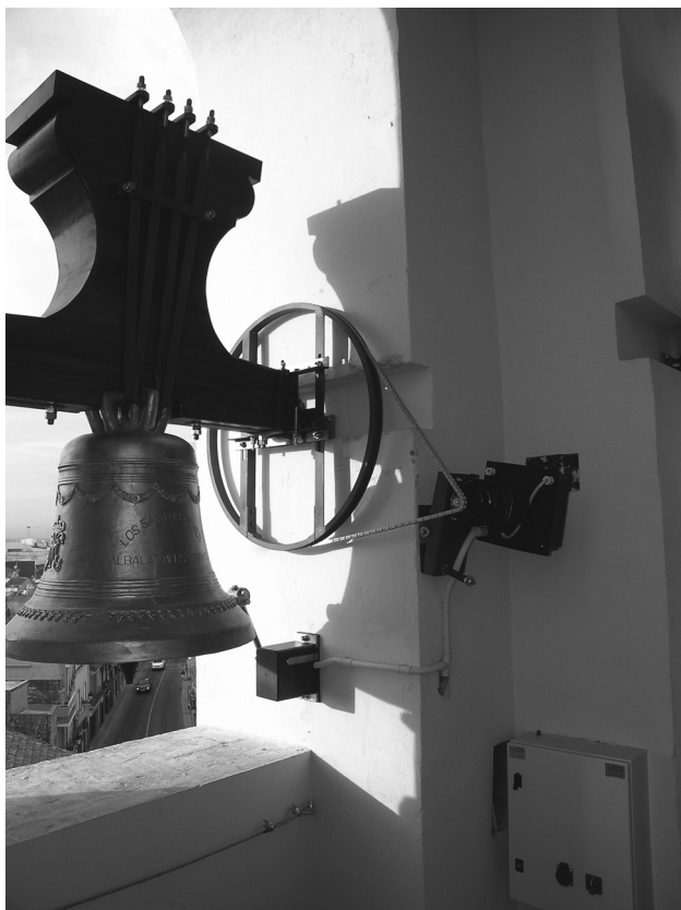
Fig. 80. Emplaçament de la campana Els Sants Reis, en què s'observa l'ancoratge final del cable d'acer de seguretat sobre el «mamperlat». I, a la part dreta, el quadre elèctric auxiliar de protecció contra sobretensions i de control de les diferents maniobres electromecàniques. En aquest armari metàl·lic també va quedar instal·lada una antena de radiofreqüència DCF. La mànega utilitzada per al cablejat dels diferents mecanismes fou la de 24x0,50 mm 2 de coure amb aïllament de PVC, i es van estendre uns 70 metres per a comunicar l'ordinador Ecat Cronos 20 ubicat a la sagristia amb l'armari esmentat.
