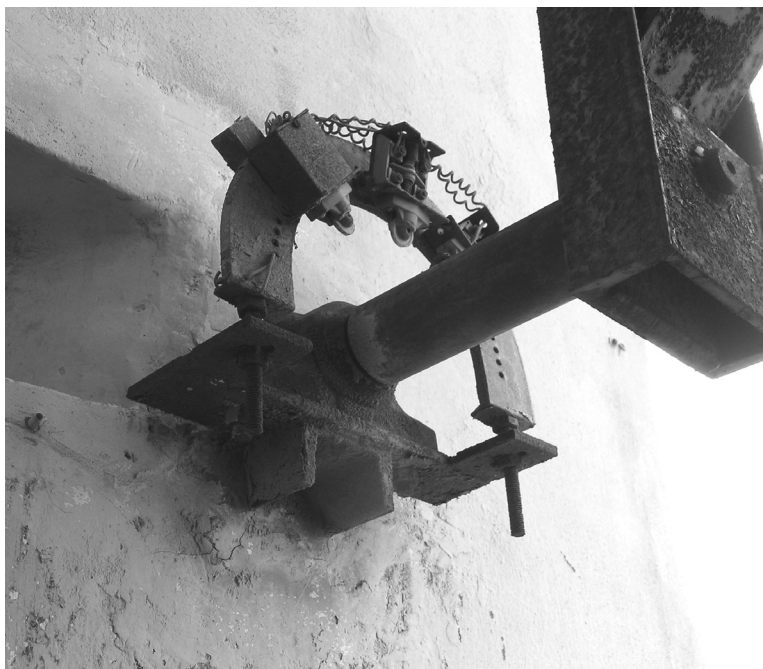
Fig. 58. Fotografia on s'observen els tres FC de la campana Els Sants Reis. Ací es veu clarament l'estat lamentable en què estava la instal·lació l'any 2006. De fet, la tapa protectora de l'aparellatge elèctric ja no estava i havien quedat a la intempèrie les connexions dels tres polsadors de retorn.
